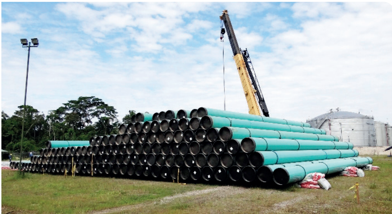
Foto 4: Tuberías para oleoducto en Ecuador
