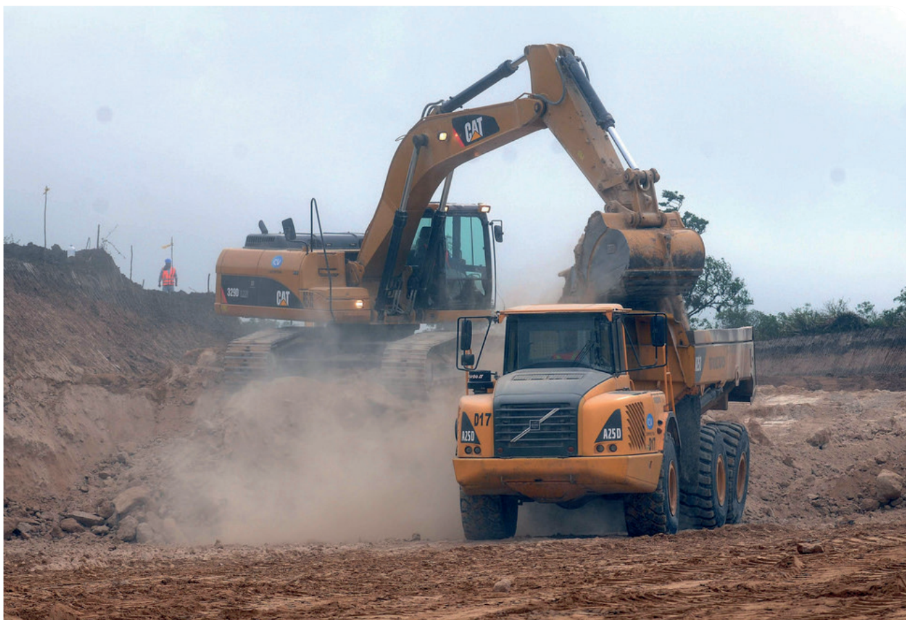
Foto 3: Construyendo una Refinería de Petróleo en Manabi- Ecuador Crédito: Santiago Armas para la Oficina de la Presidencia de Ecuador
